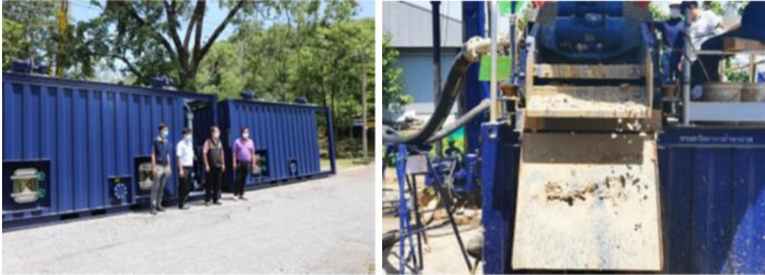
รูปที่ 4-37 ระบบหมุนเวียนน้ำโคลนสำหรับเจาะ
