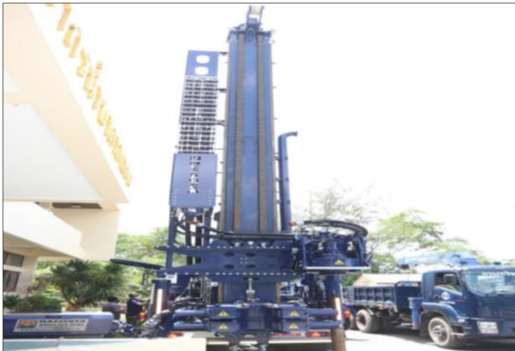
รูปที่ 5-10 เสากะโถง (Drill Mast)
