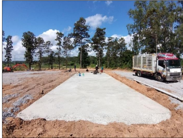
ก. ปรับพื้นที่และจัดทำฐานปูนเสริมเหล็ก เพื่อวางเครื่องจักร
