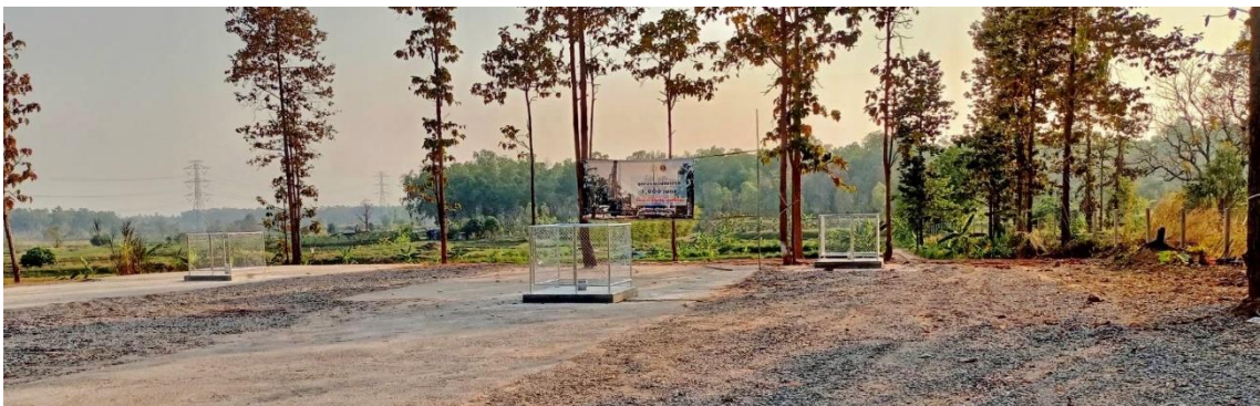
รูปที่ 4-49 การก่อสร้างบ่อน้ำบาดาลพร้อมจัดทำฐานล้อมรอบบ่อ
