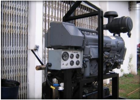
เครื่องยนต์ต้นกำลังสำหรับปั้มน้ำบาดาล
