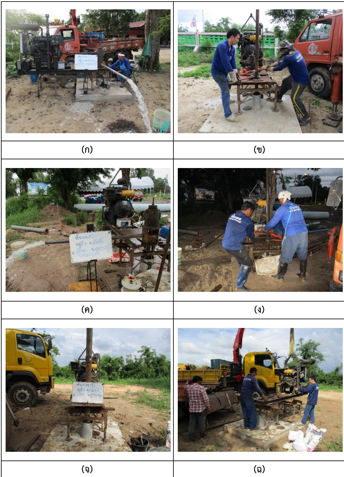
ภาพที่ 3- 19 (ก-ฉ) ภาพแสดงขั้นตอนการปฏิบัติงานสูบทดสอบปริมาณน้ำบาดาลในภาคสนาม บ้านหนองบัว หมู่ที่ 7 ตำบลดิ่งชัน อำเภอเมืองสุพรรณบุรี จังหวัดสุพรรณบุรี
