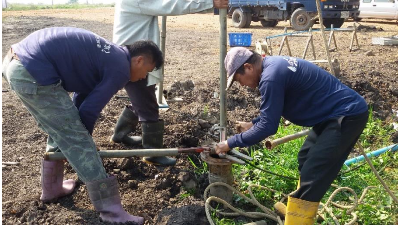
รูปที่ 3-4 การถอนชุดเครื่องสูบน้ำขึ้นจากบ่อน้ำบาดาล ตรวจสอบวัดความลึกบ่อน้ำบาดาล และวัดระดับน้ำ
