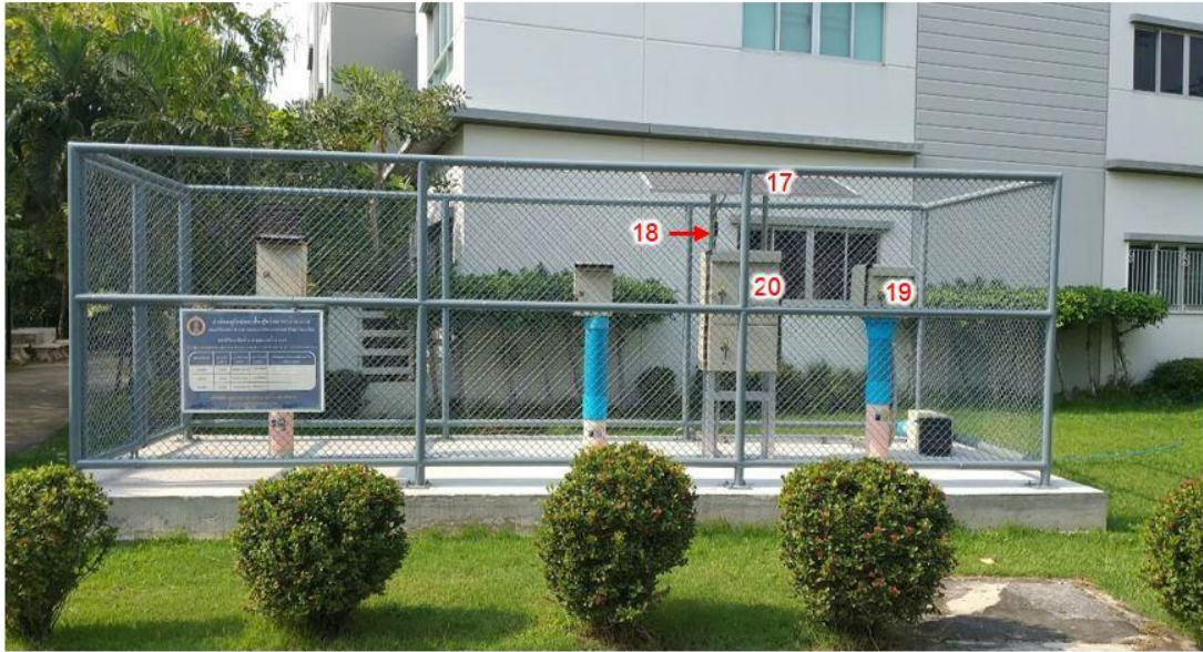
รูปที่ 4.9 อุปกรณ์ภายนอกตู้ควบคุม
