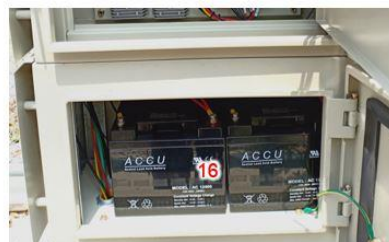
รูปที่ 4.8 อุปกรณ์ภายในตู้ควบคุม
