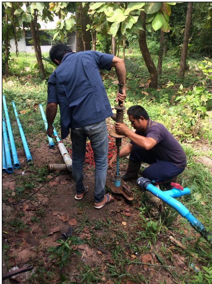
รูปที่ 3-5 การติดตั้งท่อสูบน้ำ (eductor pipe)
