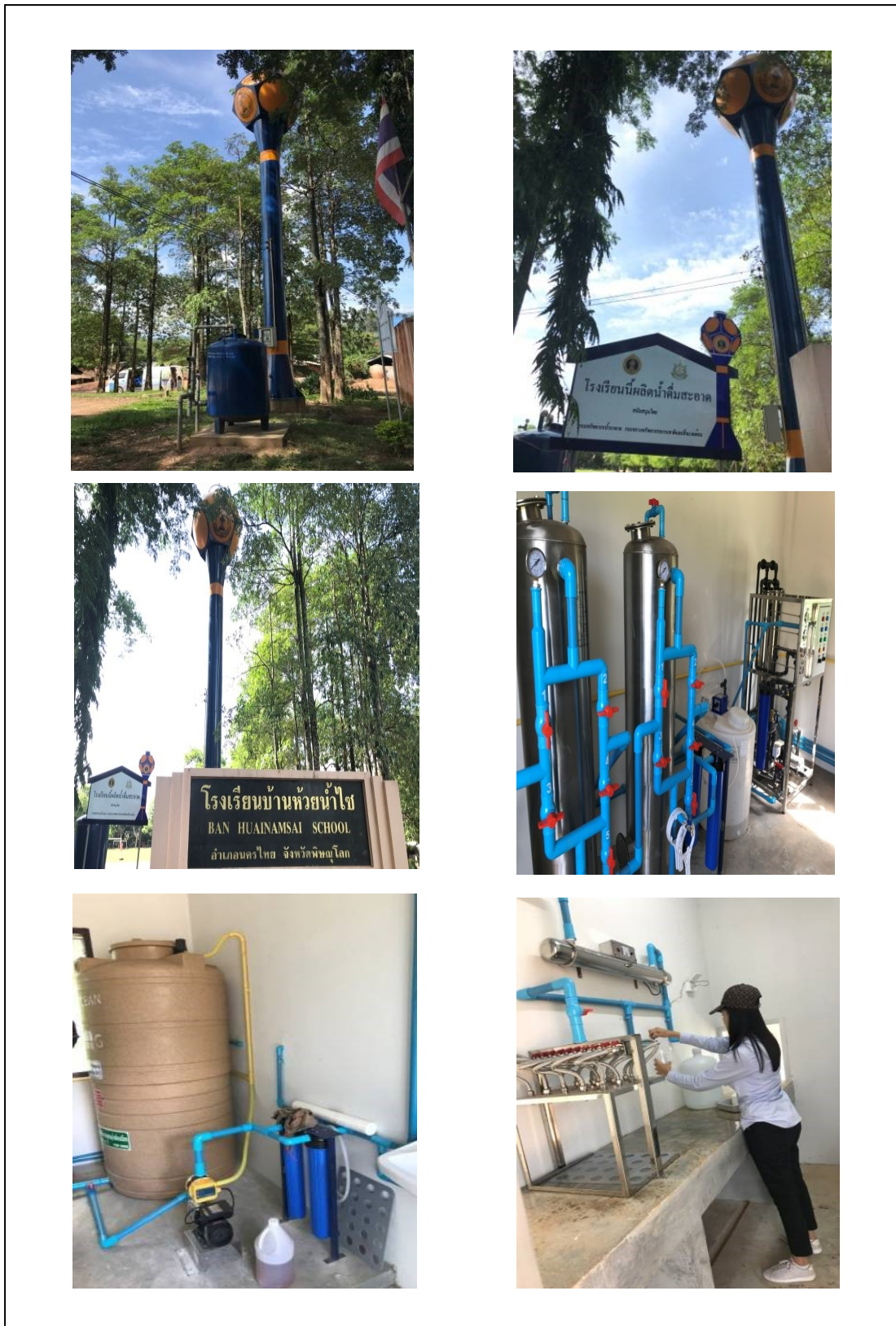
การสำรวจระบบประปาจากโครงการพัฒนาแหล่งน้ำบาดาลเพื่อสนับสนุนน้ำดื่มสะอาดให้กับโรงเรียนทั่วประเทศ
