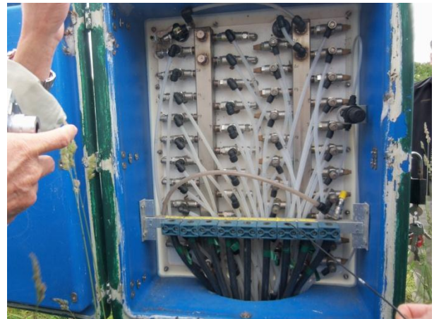
รูปที่ 14. สายต่อจากความลึกเก็บตัวอย่าง แบบ multi-depth sampling สามารถต่อเครื่องสูบน้ำจากท่อที่ปรากฏอยู่
