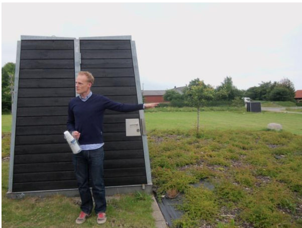
รูปที่ 6. แสดง Housing ของบ่อผลิตน้ำบาดาล
