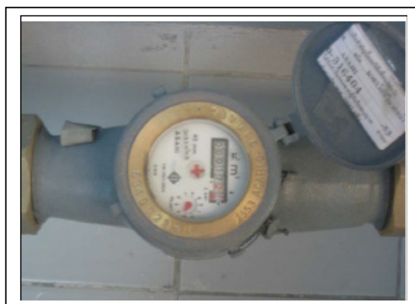
มาตรวัดน้ำเย็นเข้าเครื่องผสม
