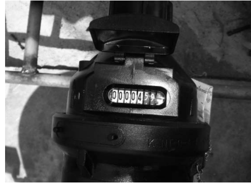
มิเตอร์ที่ปัมน้ำจากสระ
