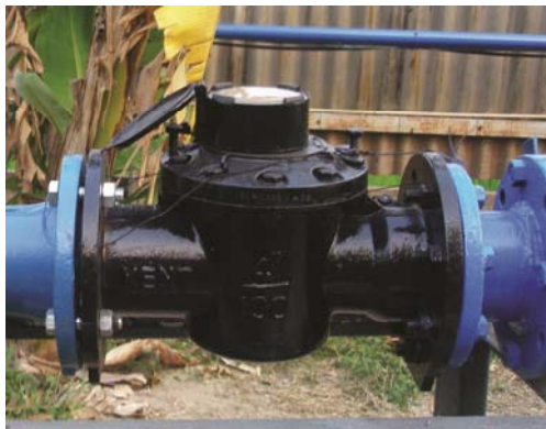
มิเตอร์ก่อนการปรับปรุง
