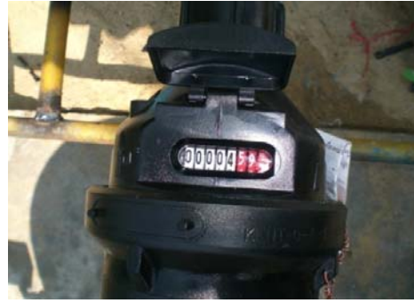
มิเตอร์ที่บิมน้ำจากสระ
