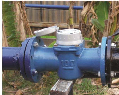
มิเตอร์หลังการปรับปรุง
