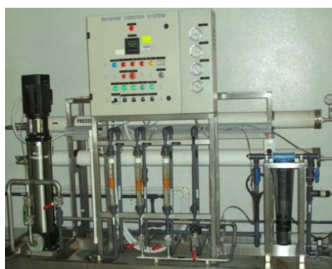
ระบบ RO
