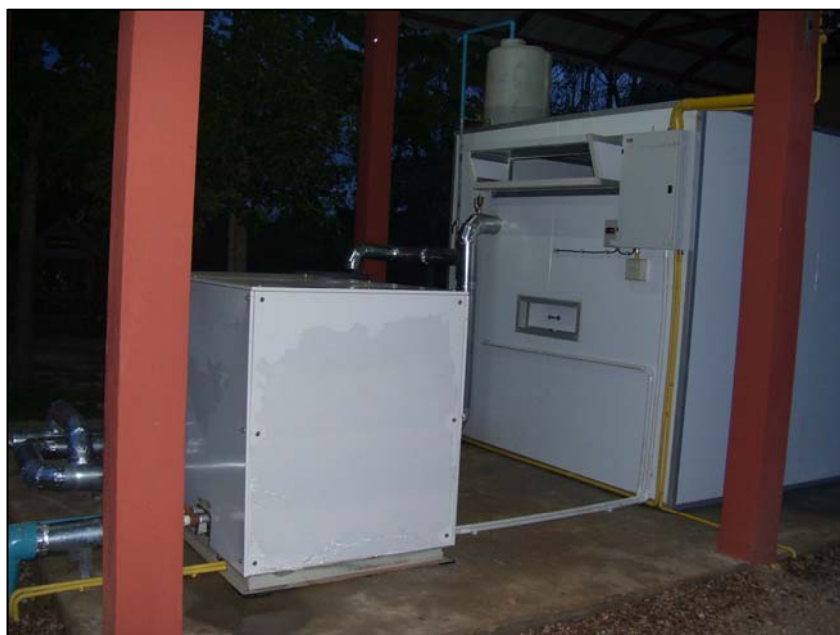
รูปที่ 5.25 ด้านหลังต้นแบบห้องอบแห้งระบบ 2 Stage Geothermal heat pump
