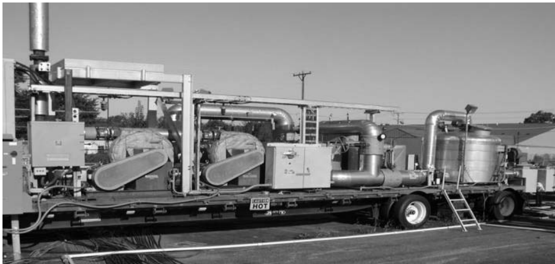
รูปที่ 6-27 อุปกรณ์ควบคุมคุณภาพอากาศที่ได้จากระบบการ thermal conductive heating
